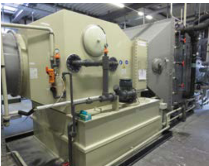
Die Wärmepumpe mit Speicher optimiert die Wärmerückgewinnung aus der Abluft.
