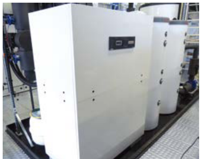
Der Abluftwäscher mit nachgeschaltetem KVS-Modul dient zur Wärmerückgewinnung.
