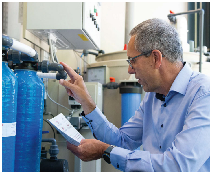
Frank Schüle, Bereichsleiter Umwelt-, Arbeits- und Brandschutz bei der Qubus GmbH, prüft Anlagenbestandteile hinsichtlich der CE-Konformität. Foto: Qubus
